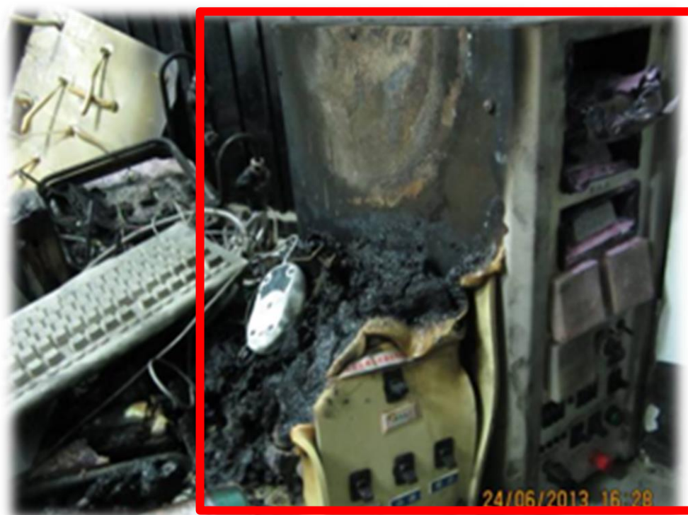
遭燒毀之精密電 鑄設備控制主機
