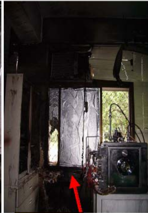
窗戶燒燬情形
