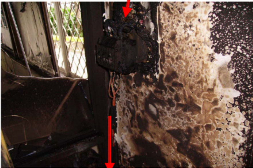
開關下方開關電線燒燬情形
