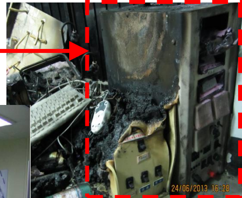
圖 3. 遭燒毀之精密電鑄設
