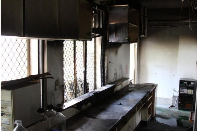
1. 燒毀的區域(實驗桌和吊櫃)
