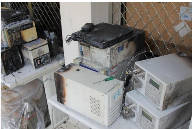
5. 燒毀之儀器設備
