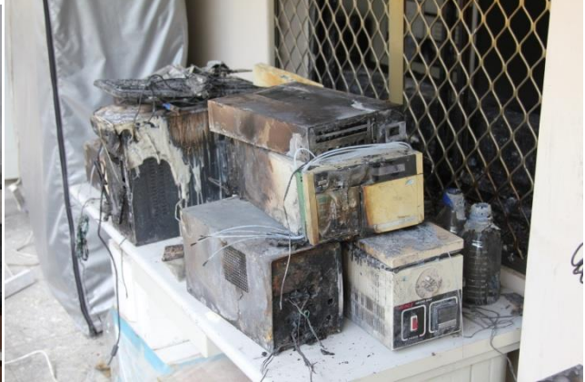
4. 燒毀之儀器設備
