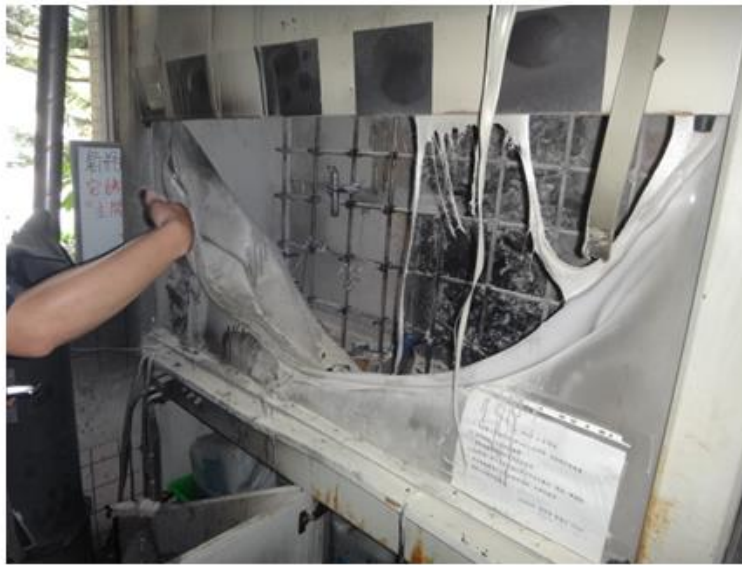
毀損之排煙櫃-壓克力視窗熔毀，局部排煙櫃背板燒焦，上方排氣管前半部毀損
