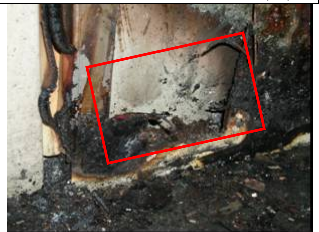
圖 4、於抽氣櫃內加裝之插座燒毀情形
