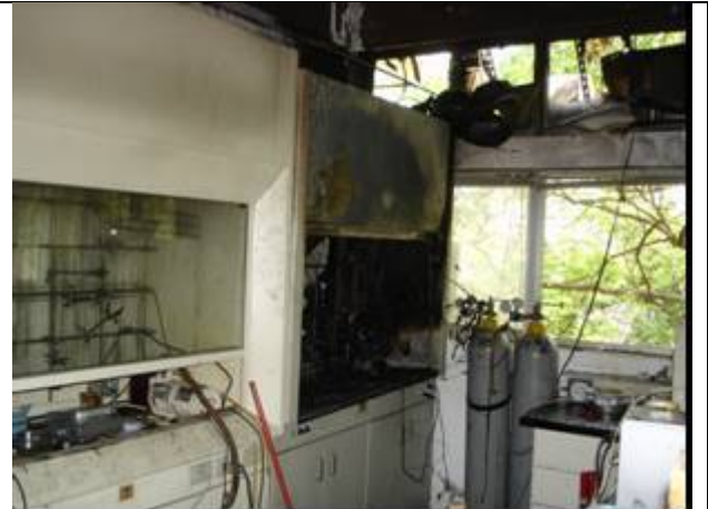
圖 2、災害現場燒毀之抽氣櫃(二)
