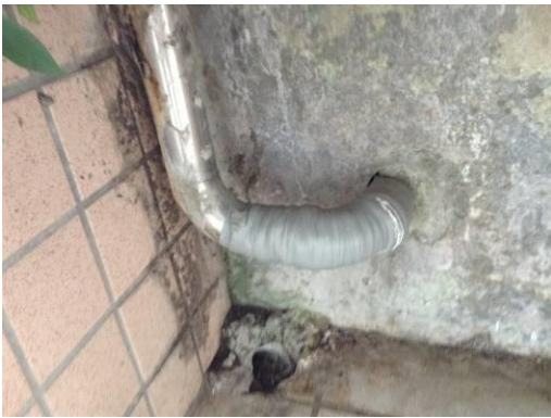
排水管設計不良(水洩不順暢)，導致水管堵塞。
