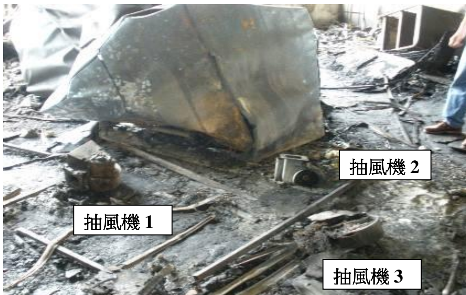
圖四 三個 PP 櫃抽風機散落情形
