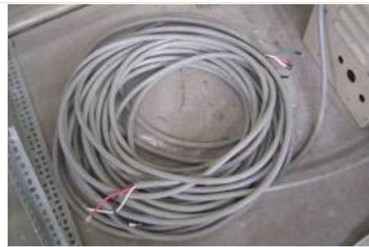
裸線接頭易有感電危害
