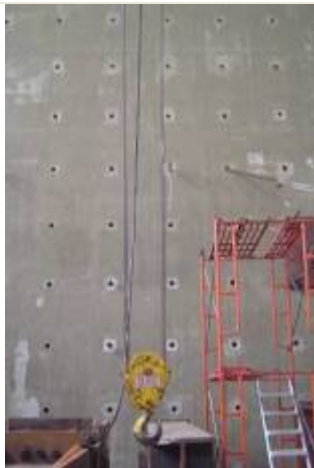
起重機鋼索因鋼樑撞擊而損傷
