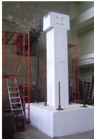
施工架內爬梯不完整
