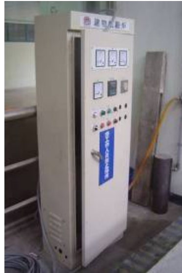
配電盤未上鎖管制
