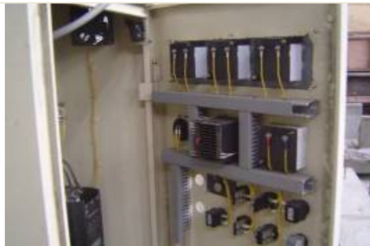
電線接頭並無防止感電裝置
