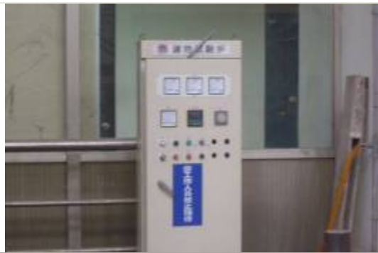
配電盤未上鎖管制
