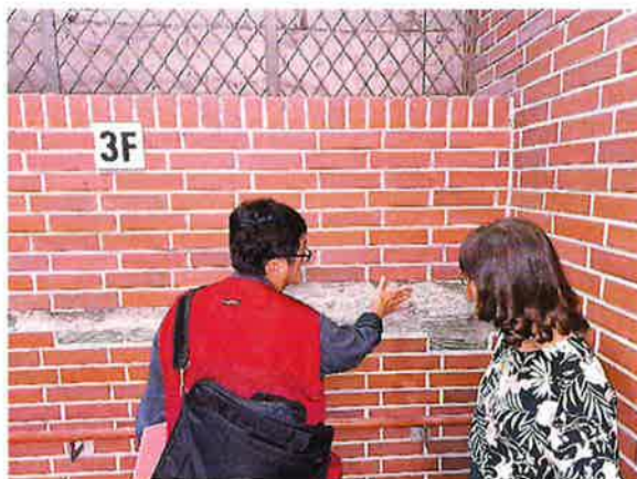
西側樓梯 2~3 樓平台牆面磁磚及水泥剝落
