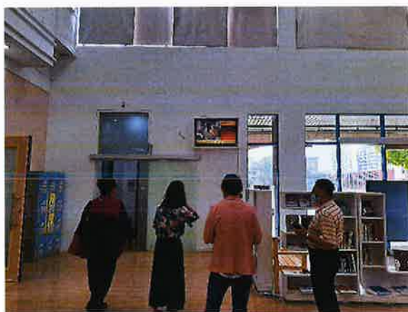
圖書館牆面龜裂
