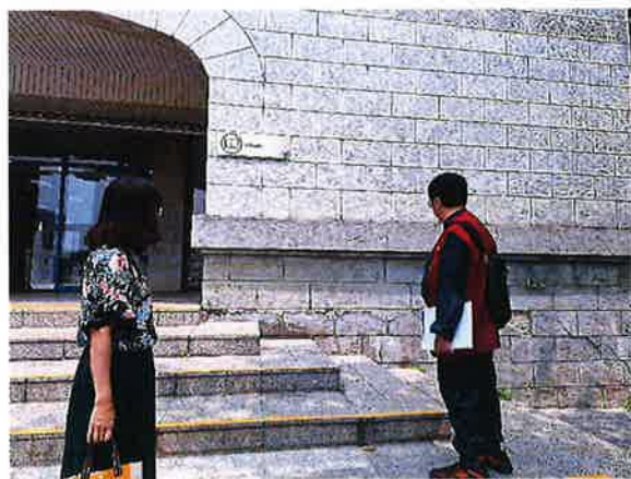
入口外牆牆面龜裂水泥剝落
