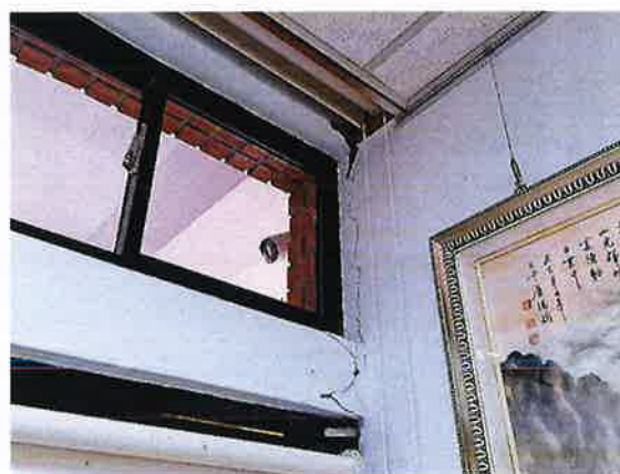
A607 校長室牆面龜裂
