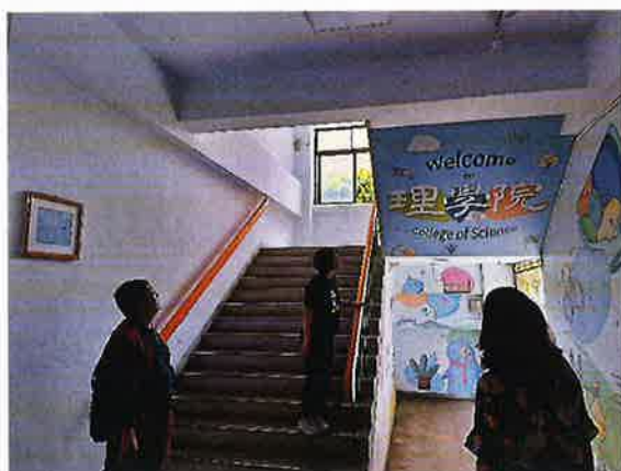
樓梯階梯龜裂
