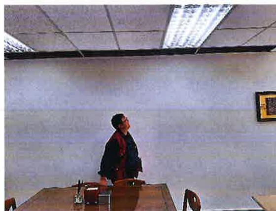
A700a 師培處及處長室天花板骨架及板材脫落
