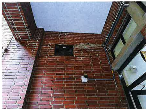
A112b 原資中心前走廊牆面磁磚剝落
