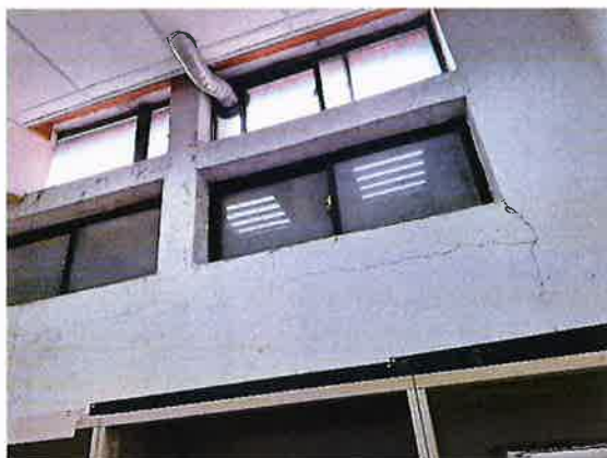
圖書館牆面龜裂，天花板骨架及板材脫落
