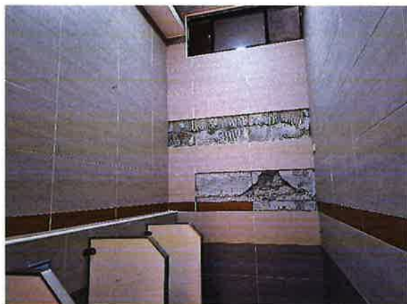
1 樓東側男廁牆面磁磚剝落
