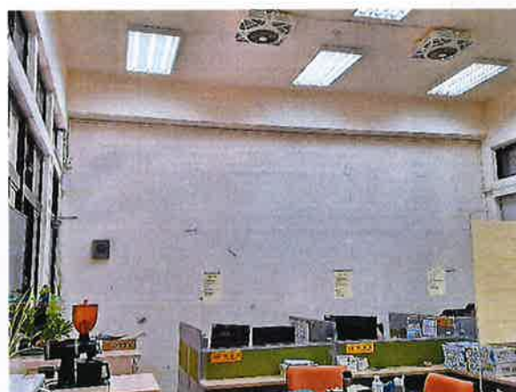
A108 校安中心磚牆及石膏板牆牆面龜裂
